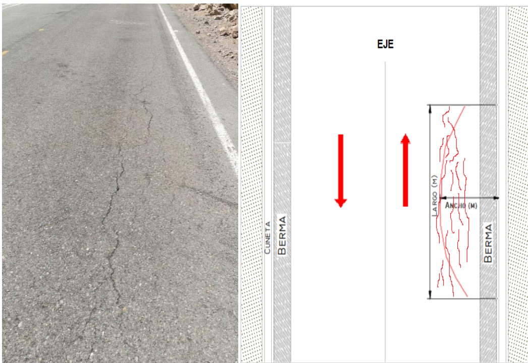
Figura 2. Fisura en media luna y fisuras con tendencia al piel de cocodrilo.
