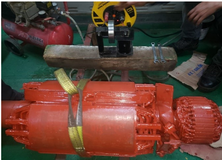
Figura 39. Rotor principal barnizado del generador Caterpillar Modelo 3304.
