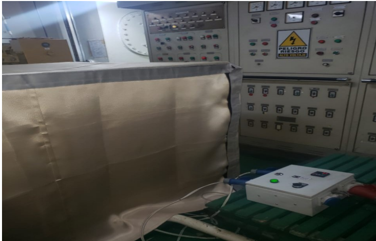
Figura 40. Cama de estufado para el sistema eléctrico del generador Caterpillar Modelo 3304
