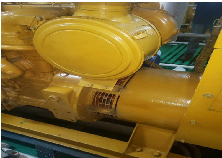
Figura 44. Rejillas del ventilador del generador Caterpillar Modelo 3304
