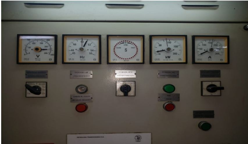
Figura 45. Consola de instrumentación del generador Caterpillar Modelo 3304
