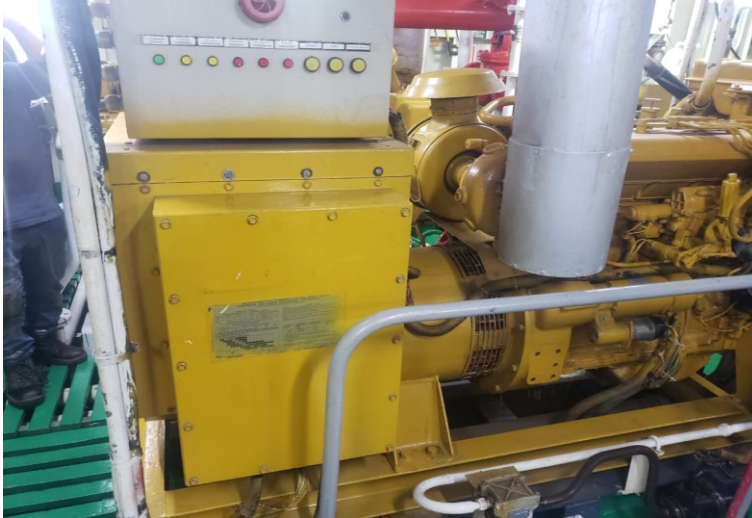
Figura 43. Acoplamiento del generador al motor, Caterpillar Modelo 3304
