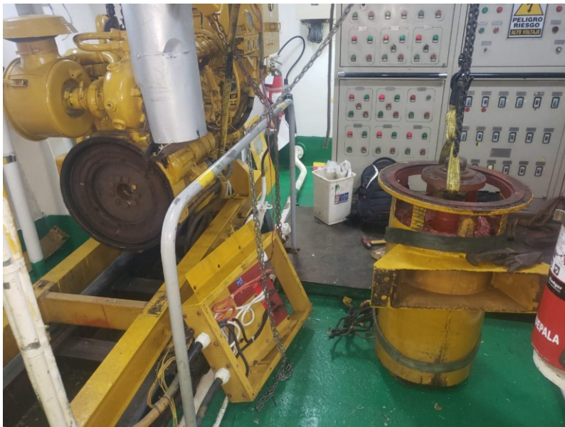
Figura 34. Parte eléctrica y mecánica del Generador Caterpillar Modelo 3304
