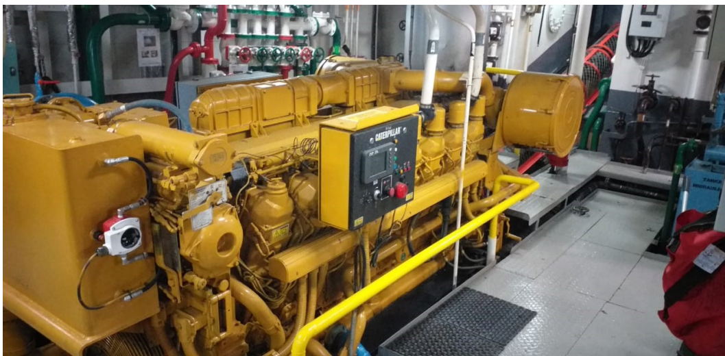
Figura 3. Generador síncrono. Fuente: PSA Marine, 2018.
