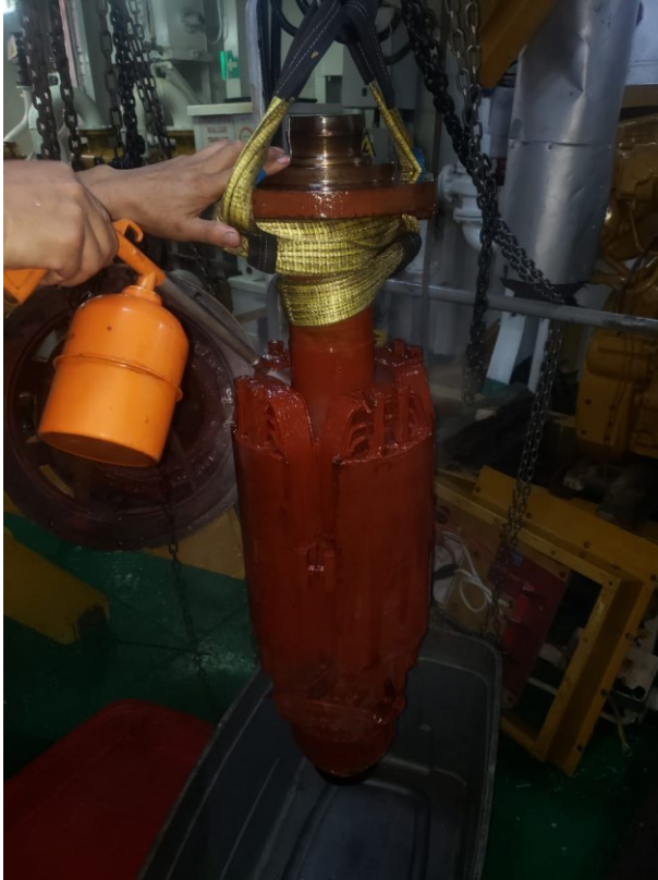
Figura 35. Rotor principal del generador Caterpillar Modelo 3304
