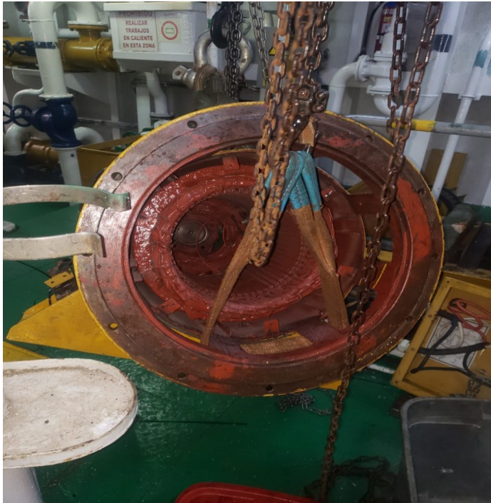
Figura 36. Bobina del estator sin barnizar el generador Caterpillar Modelo 3304
