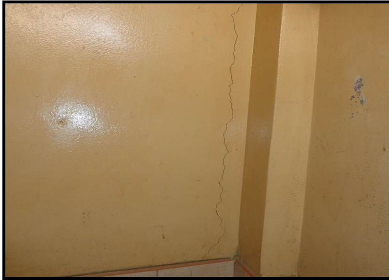
FOTO 6.9: Muros agrietados (vivienda 21)
