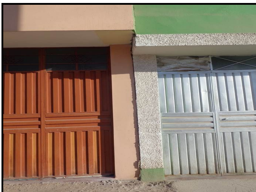
FOTO 6.3: Carencia de junta sísmica entre viviendas (vivienda 02)
