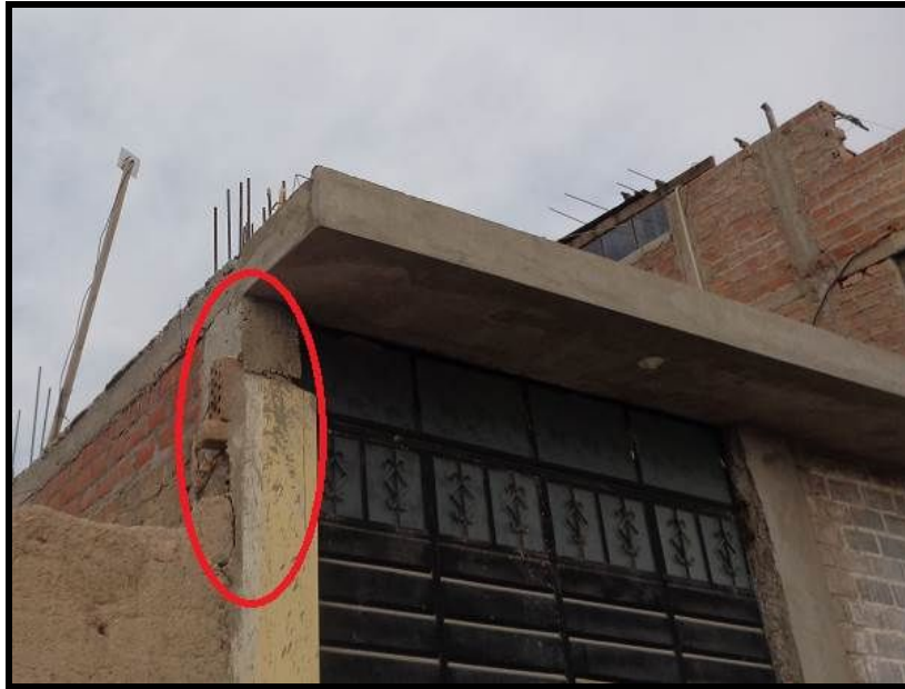
FOTO 6.8: Discontinuidad vertical por mal encofrado de columna (vivienda 17)
