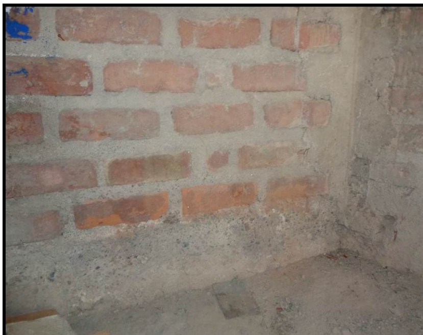
FOTO 6.11: Baja calidad de ladrillos (vivienda 07)
