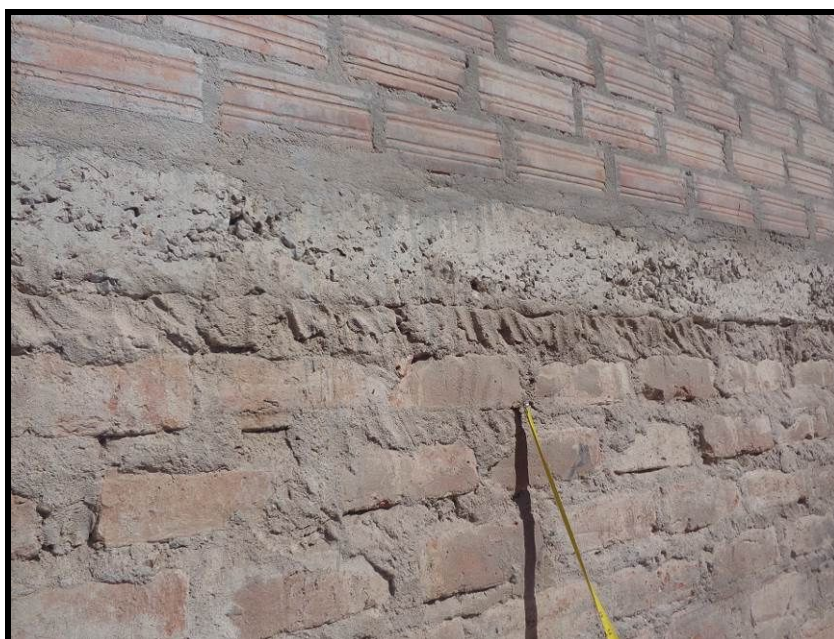
FOTO 6.7: Inadecuado confinamiento de muro (vivienda 14)
