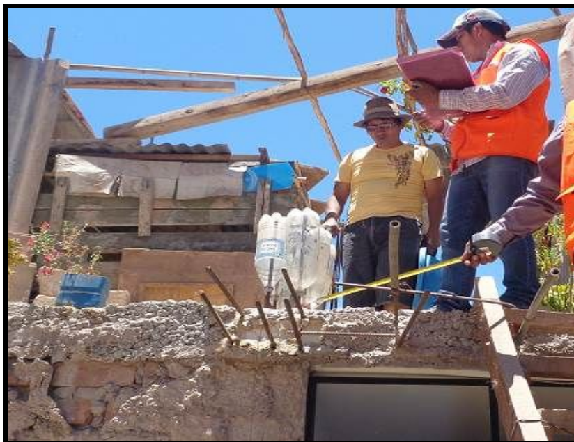
FOTO 6.6: Acero de viga expuesto proyectado (vivienda 11)
