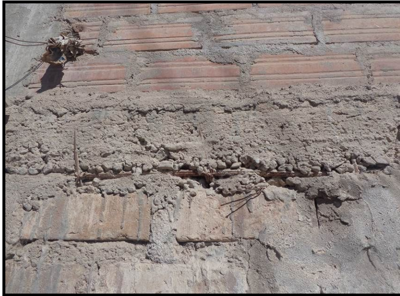
FOTO 6.5: Acero de viga expuesto por falta de recubrimiento (vivienda 14)
