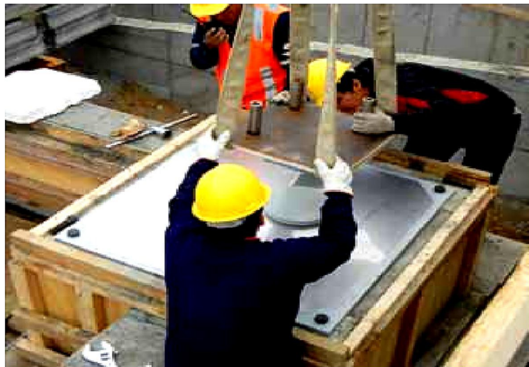
Figura 7. Apoyo deslizante plano en la Universidad Católica del Maule Fuente: Cámara Chilena de la Construcción, 2011
