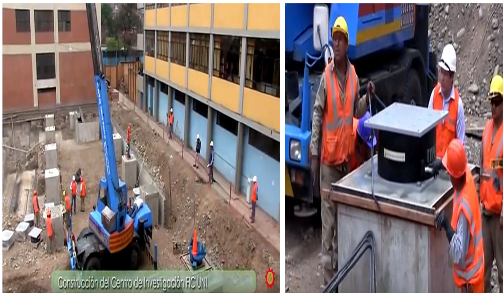
Figura 12. Primer edificio con aislador sísmico en el Perú, Centro de Información e Investigación de la Facultad de Ingeniería Civil de la Universidad Nacional de Ingeniería (FIC-UNI) Fuente: Carranza, S. F.
