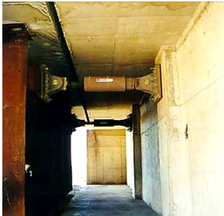
Figura 29. Aplicación amortiguador viscoso. Puente Amolanas (Chile) Fuente: Cámara Chilena de la Construcción, 2011
