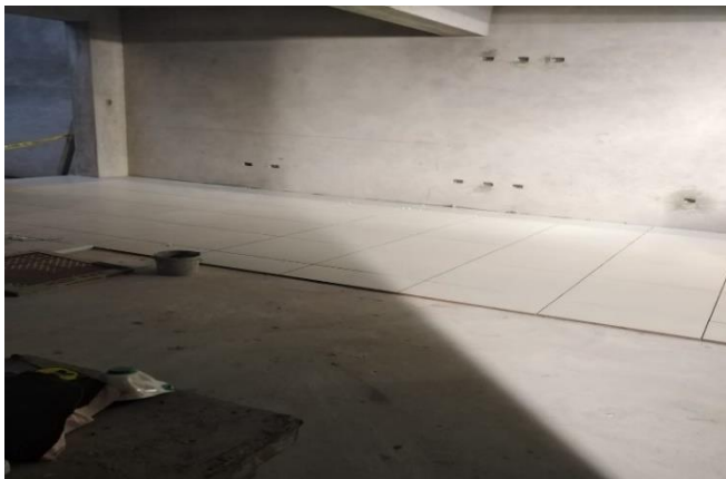
Piso cerámico de alto tránsito 0.60x0.60 m
