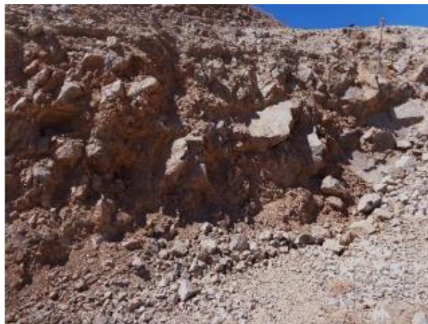
Figura 64. Cortes de talud temporal del tercer corte superior. Nótese el comportamiento clástico en el cuerpo del aglomerado con tendencia a descompresión y generar inestabilidad de bloques aislados de roca.
