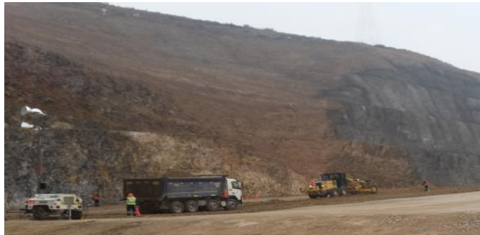
Figura 66. En el talud central se encontró material suelto en el hombro del talud 2 y roca dura en el talud 1
