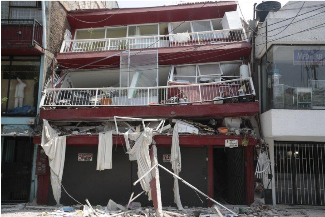
Figura 13. Colapso parcial de edificio después del terremoto de México 2017
