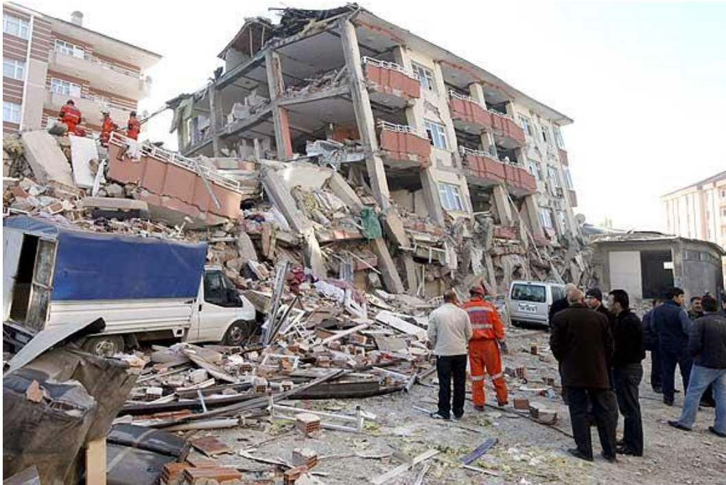
Figura 11. Daños en edificaciones terremoto de Turquía de 2011
