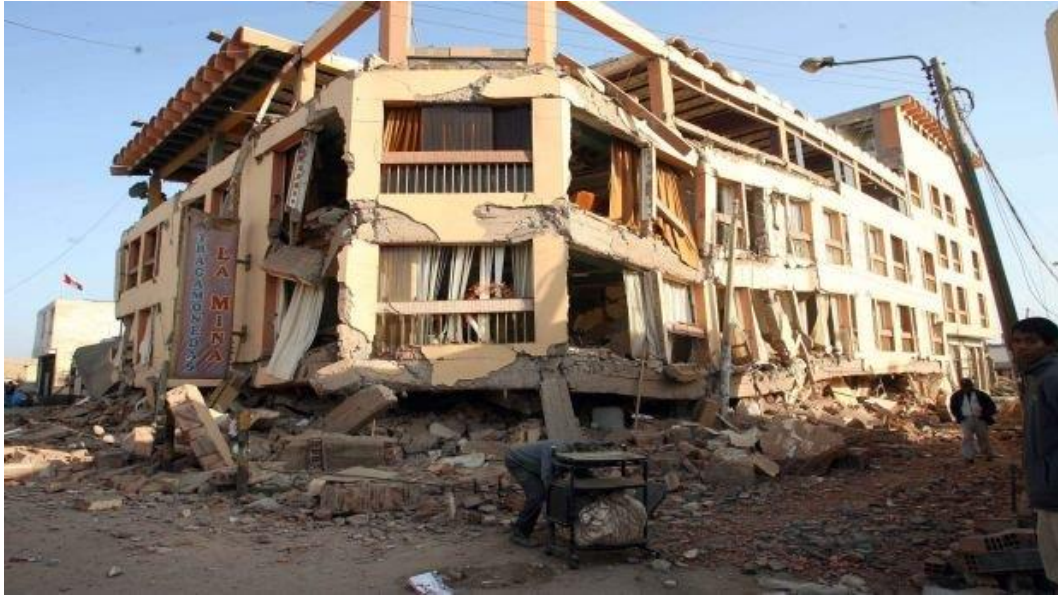
Figura 8. Escombros del hotel Embassy tras el tremendo remezón
