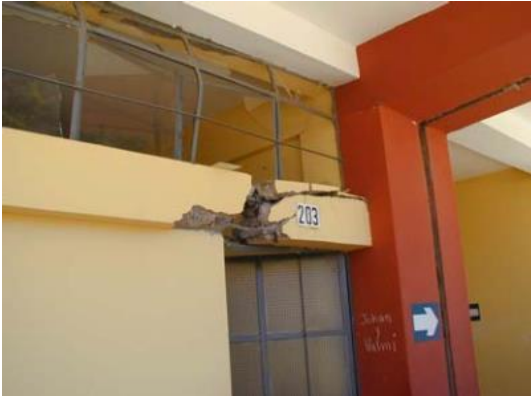
Figura 6. Daños en columnas, tabiquerías y viga intermedia, UJCM-2001
