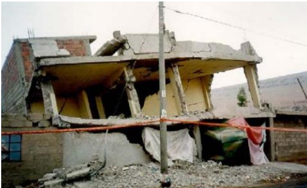
Figura 7. Vivienda colapsada por uso de pórticos flexibles, Tacna 2001
