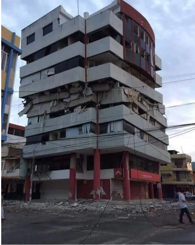
Figura 10. Daños en edificio después del terremoto de Ecuador, 2016
