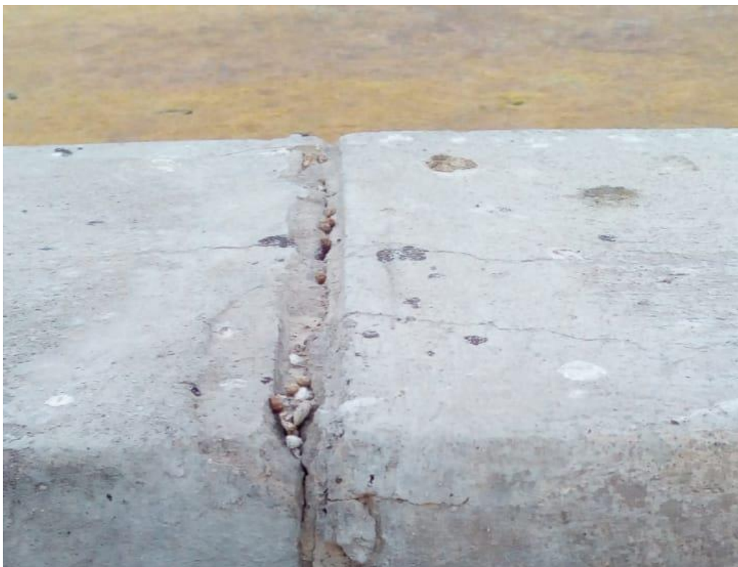
Figura 7. Detalle de fisuras en tarrajeo y deterioro del material sellante
