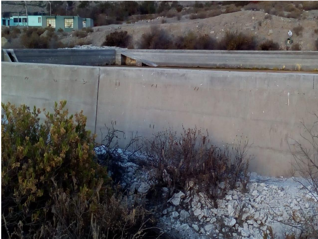
Figura 6. Juntas de dilatación muy distantes
