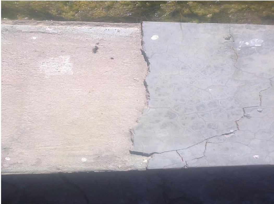
Figura 4. Detalle de resquebrajamiento del tarrajeo Nota: El resquebrajamiento se origina en la corona del reservorio
