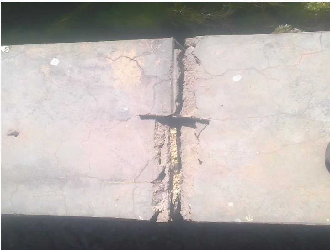
Figura 3. Detalle de fisuras en tarrajeo
