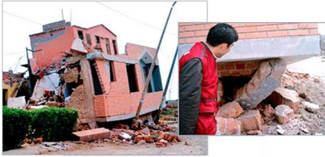
Figura 2. Vivienda afectada por el terremoto de Pisco. 15 de agosto del 2007
